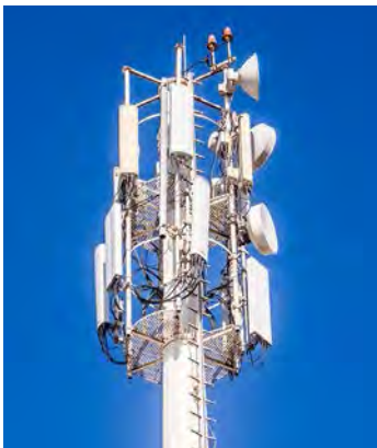
Mobilfunkmast einer Basisstation mit rechteckigen Mobilfunkantennen und runden Richtfunkantennen
